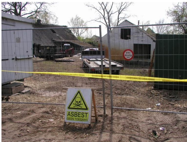
Figuur 17: Afscherming van een asbestverdachte locatie
