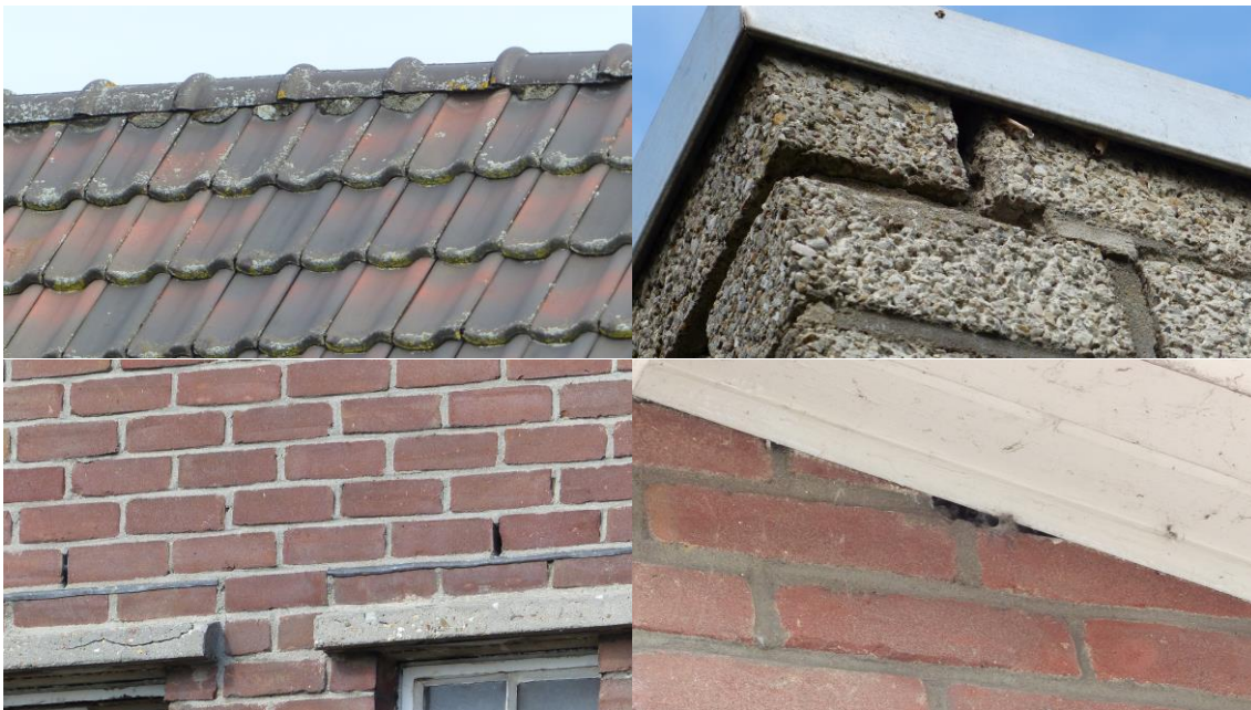
Figuur 4.6 Binnen het plangebied zijn verschillende toegangsmogelijkheden voor vleermuizen in gebouwen aanwezig: nokpannen (linksboven), daktrim (rechtsboven), open stootvoegen (links onder) en missende stukken steen (rechtsonder).
