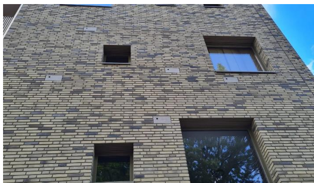
Figuur 3-11 Inbouw nestkast type HMP2 in gevel (bron: Unitura).
