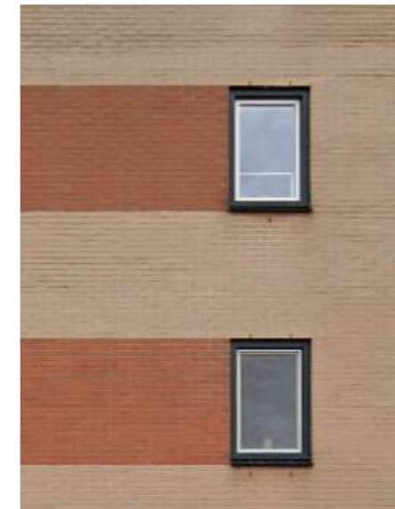
Baksteenwerk met kleurverschillen
