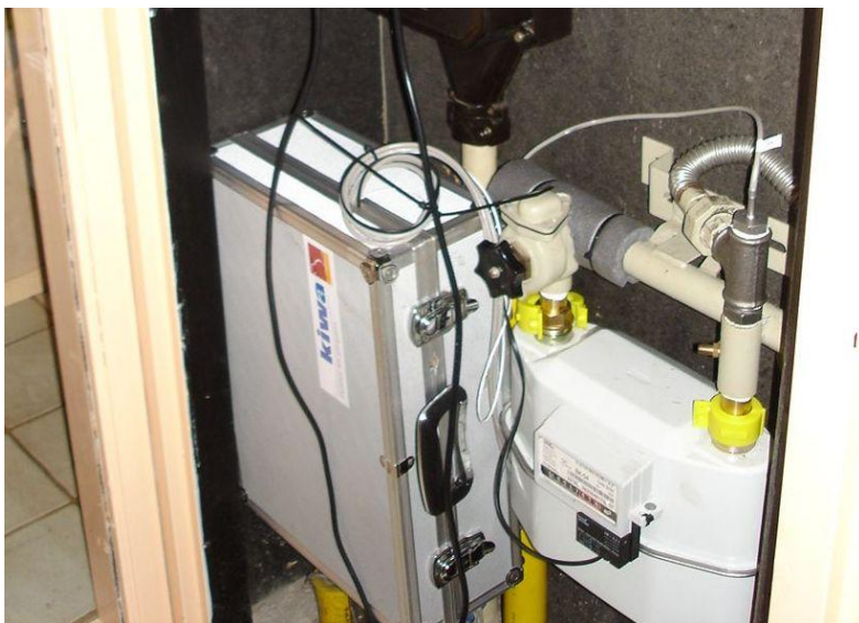
Figuur 1: Voorbeeld van een geïnstalleerde meetset in een meterkast
